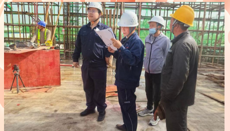
华峰公司青年职工勇担时代使命、扎根项目建设一线紧扣施工进度、严守工程质量、筑牢安全防线，以实干实绩为企业项目建设提速增效。（李若冰）
