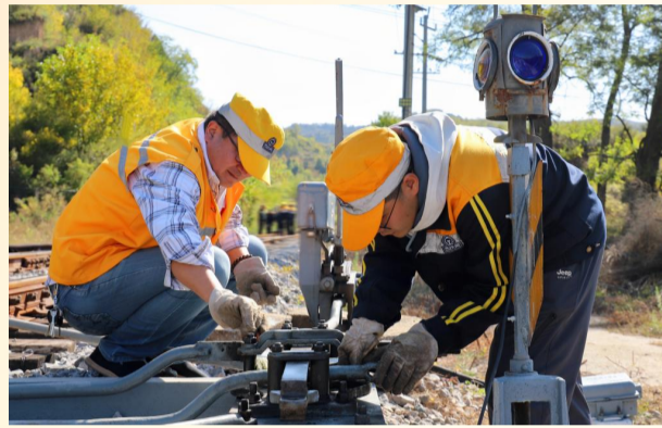
铁运分公司青年职工立足行车调度、线路维护等关键岗位，践行五四初心、坚守使命，苦练业务本领，主动投身安全生产、技术创新等工作，以青春担当护航铁路运输畅通，用实干书写服务企业发展的青春答卷。（张洋）
