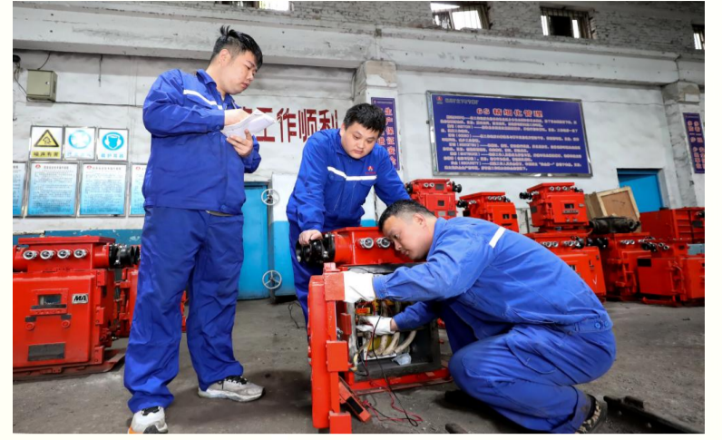
下石节矿青年职工紧盯主通风、供电等关键系统，带头开展巡检、隐患排查与设备检修，指导青工实操练兵、提升应急处置能力，以实干筑牢机电安全防线，护航节日期间矿井安全生产。（魏璐）
